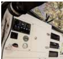
Bedienfeld und 220-Volt-Steckdose
